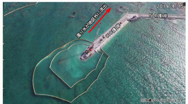
護岸工事を着工して1年が経とうとしているが汚濁防止膜の外に濁り水が流出するずさんな工事
