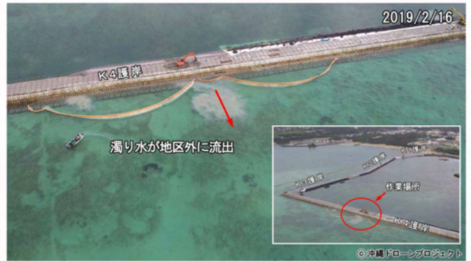
被覆ブロックの隙間に砂利を敷き詰める作業をしているが、防止膜設置の不備で濁り水が流出している
