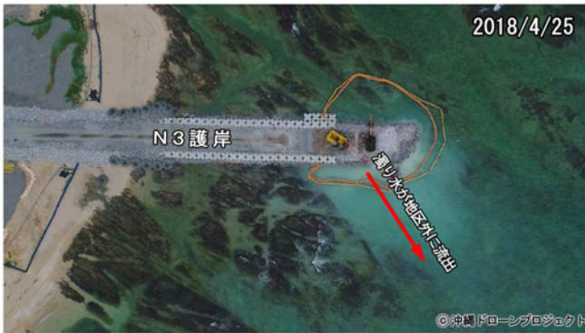
N3護岸の施工時に汚濁防止膜を設置しているが濁り水が流出しているのが確認できる
